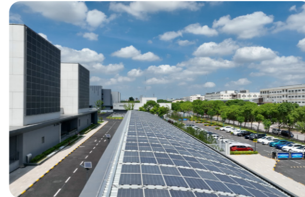
万国数据浦江数据中心园区光伏发电应用场景
